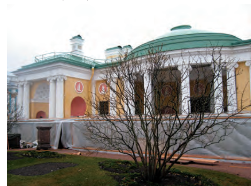
Висячий сад в Царском Селе (на снимке — фрагмент его террасы у входа в павильон «Холодная баня») перед реставрационным ремонтом исторической системы гидроизоляции
