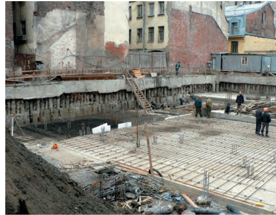
Строительство гостиницы Sokos Hotel Vasilievsky и ее главный фасад после сдачи «под ключ»
